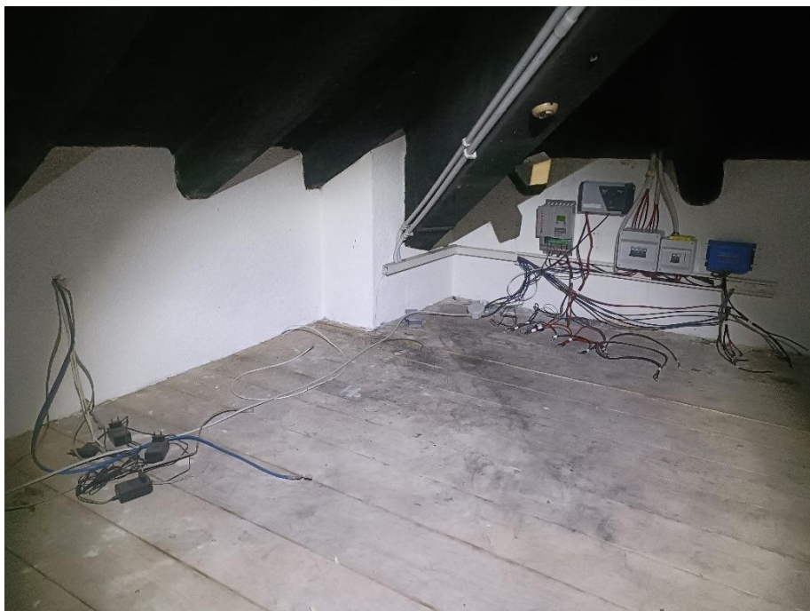
Foto 39 – MALGA TASSULLA – SOFFITTA – LOCALE BATTERIE. Foto di data 29.10.2025
