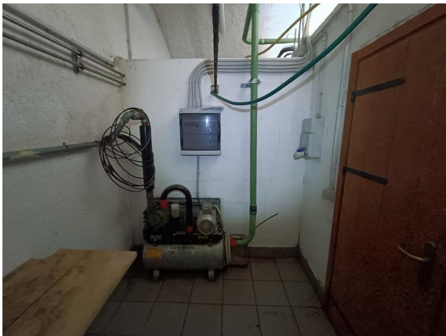
Foto 51 – STALLONE – LOCALE POMPA DEL VUOTO MUNGITURA. Foto di data 29.10.2025
