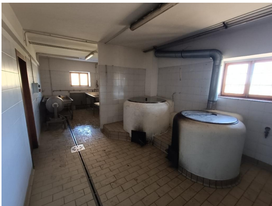
Foto 20 – MALGA TASSULLA – LOCALE CASEIFICIO – COTTURA. Foto di data 29.10.2025
